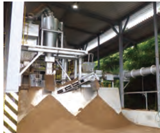
家畜排せつ物処理装置
